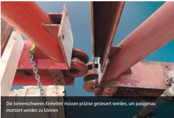
Imposantes Bauwerk: der wachsende Traggerüstbogen, der von beiden Seiten zum Scheitelpunkt hin montiert wird
